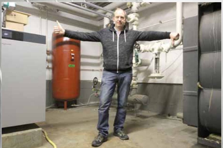
Der neue Gasbrennwertkessel bringt „nur“ maximal 80 kW Leistung, gegenüber dem alten mit 400 kW (rechts), doch dank energetischer Sanierung ist das kein Problem.
